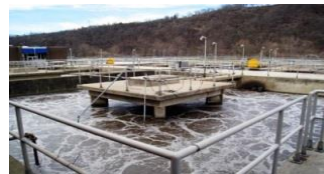
การบำบัดน้ำเสีย
